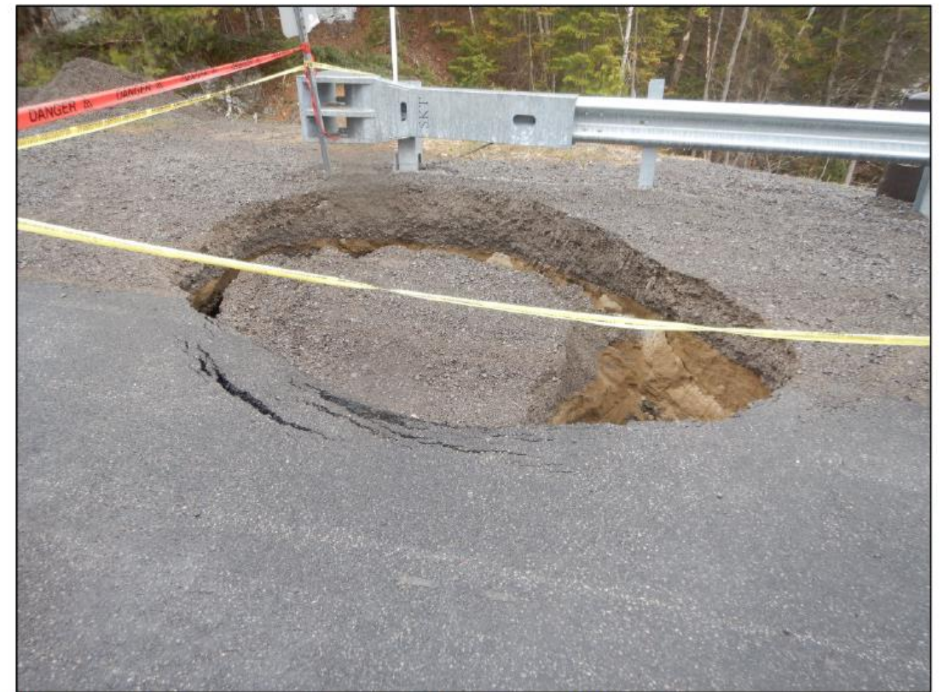
Figure 3 : Effondrement observé sur la chaussée de la route.
