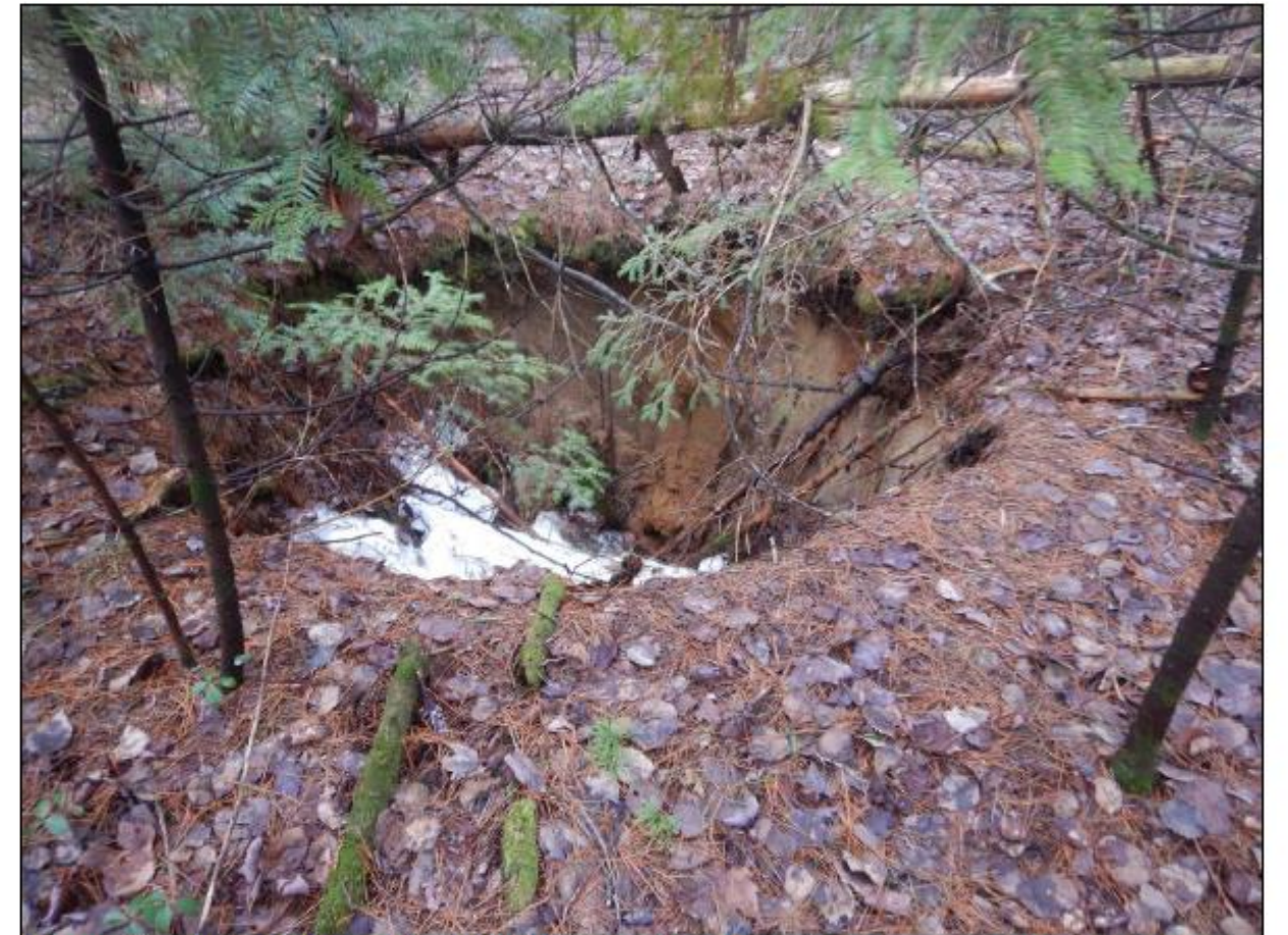
Figure 7 : Doline observée en 2018 dans les sols naturels, en sommet de talus sur la rive droite du ruisseau Bellemare.
